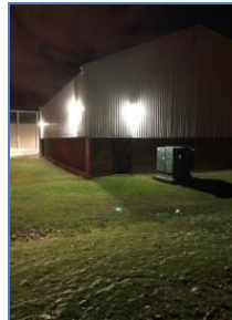
Boîte électrique à l'arrière de la piscine est éclairée
