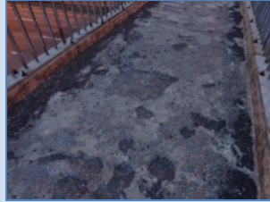
Mauvais état de la passerelle
