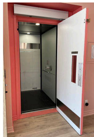
Le monte-personne permet de se déplacer entre les étages.
